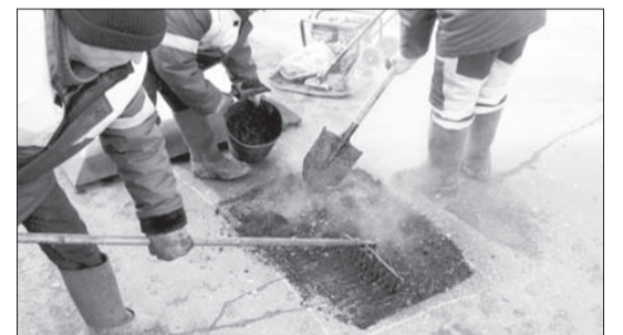
Дефекты - на совести нерадивых подрядчиков
