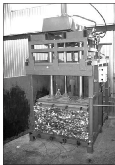
Сейчас в «Центре экологических технологий» работает единственная в городе мусоросортировочная линия производительностью до 180 тысяч тонн в год и оборудование для переработки сырья - агломераторы и прессы
