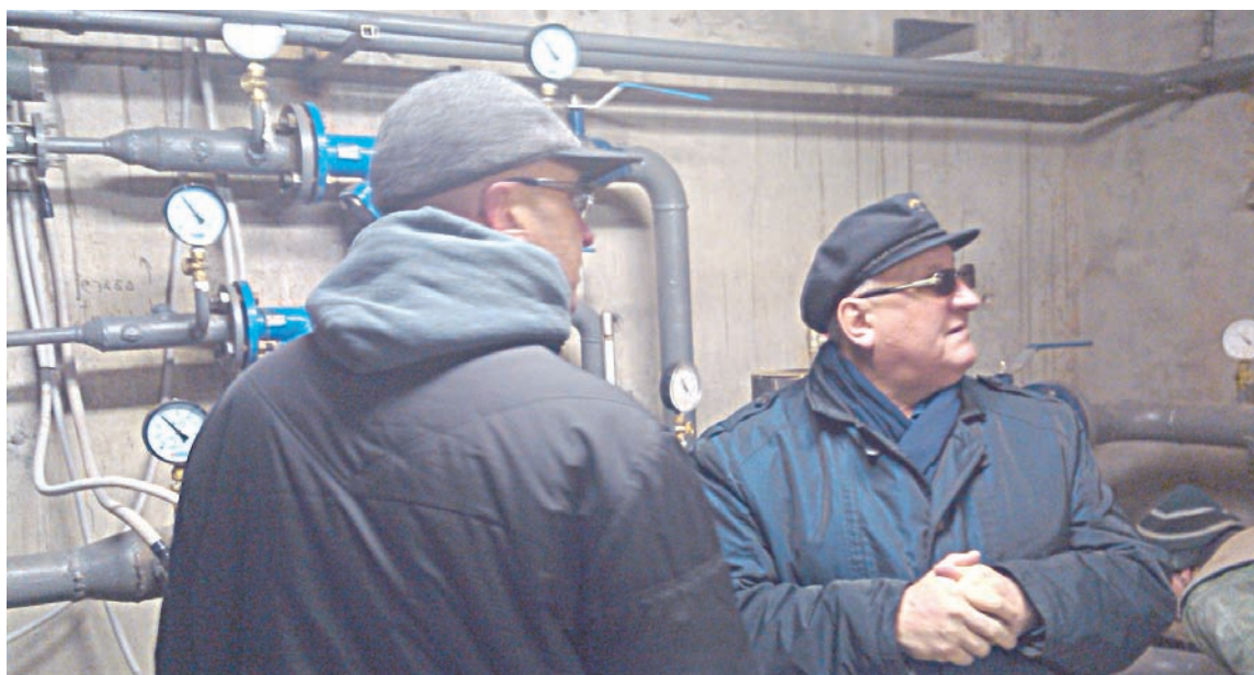
Анатолий Бакаев лично осматривает уже работающий тепловой узел дома.
