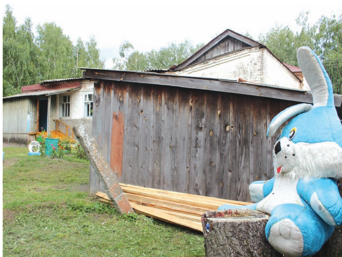
Игрушкам пора на заслуженный отдых, зданию – на ремонт.
