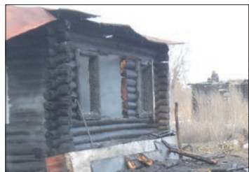
В результате пожара дом выгорел полностью.
