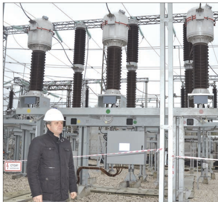
Заместитель директора по капитальному строительству Александр Кочетов на ПС «Центральная».
