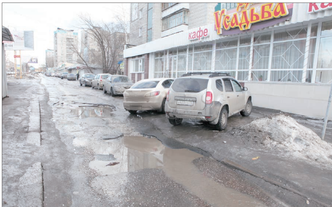
На ремонт дорог выделяют колоссальные деньги. А где обещанное качество?
